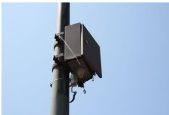
脱落寸前まで朽ちた制御盤
