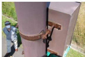
支柱と制御盤の取付部
